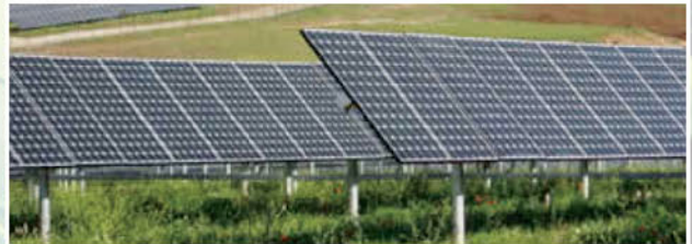
Strasskirchen Solar Park
