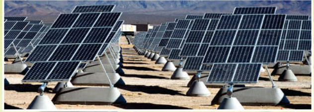
Nellis Solar Power Plant
